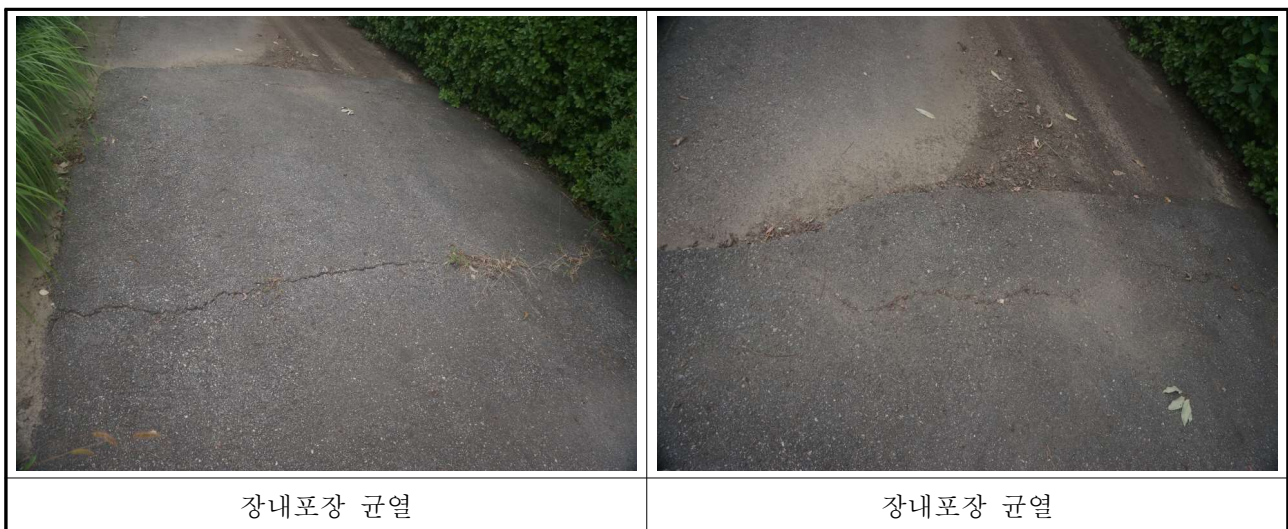
【사진 3.9】 기타 부대시설 손상사진
